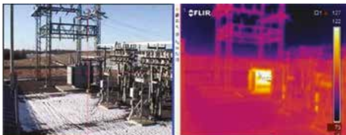
变电站的数码照片及红外图像，其中显示的是一台温度过高的变压器。
